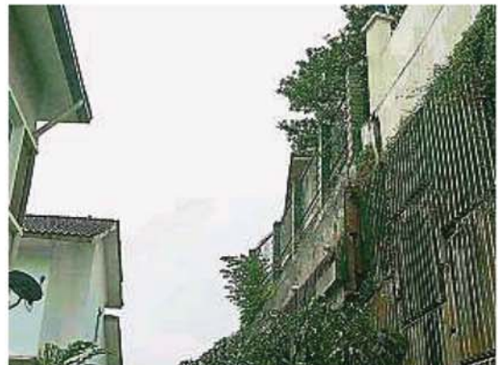
位于高地的洋房后墙崩裂，危及屋后位于地势较低处的房子。
